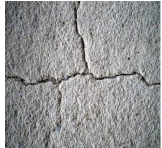
Ettringitbildung unter dem Verputz
